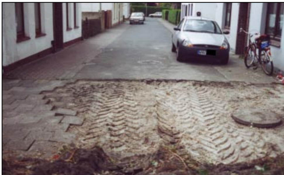
Und so sieht es jetzt am Ende der Hermannstraße, wo früher ein üppiger Rosenstrauch stand, aus: Die Bewohner der Häuser 1 und 2 erreichen den Nordteil ihrer Grundstücke nur noch durch eine (je nach Wetter) Sand- oder Matschkuhle. Nummer 2 kann seine Garagen nicht nutzen; Nummer 1 kann kein Heizöl angeliefert bekommen. Ein nur durch einen Betondeckel bedeckter Schacht mitten in einem 'Sandkasten' lockt Kinder unwiderstehlich zum gefährlichen Spiel. Der neue Eigentümer des Bunkers kann seine geplanten Baumaßnahmen nicht in Angriff nehmen, solange die Straße nicht gepflastert ist. Ist seinen Nachbarn im Moment die Nutzung ihrer Grundstücke verwehrt, so verliert er durch Nutzungsausfall Geld.
